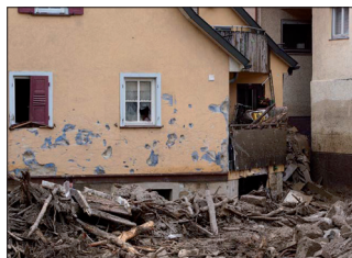
Schäden an Häusern
