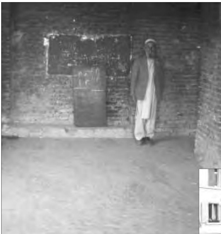
Das alte Schulgebäude in einem renovierungsbedürftigen Zustand.
